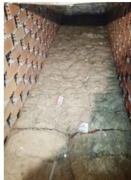
Figura 4. Aislamiento en mal estado en entrecubierta no habitable.
