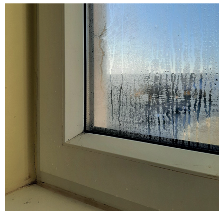
Figura 1: Condensación superficial sobre ventana.
