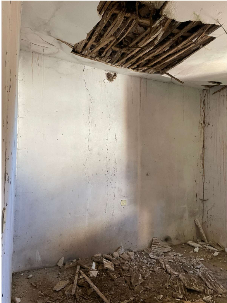
Ilustración 18. Foto interior. Desprendimiento de los forjados de la Casa del Cordón de Valdecañas de Cerrato. Fotografía propia, 28 de enero de 2022.
