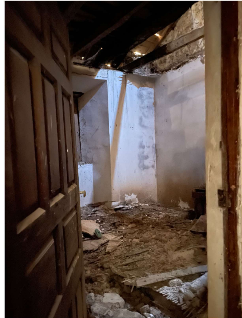
Ilustración 17. Foto interior. Desprendimiento de los forjados de la Casa del Cordón de Valdecañas de Cerrato. Fotografía propia, 28 de enero de 2022.
