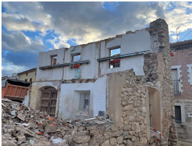
Ilustración 34. Demolición de la fachada de la Casa del Cordón de Valdecañas (Palencia). Fotografía propia, 10 de marzo de 2022.
