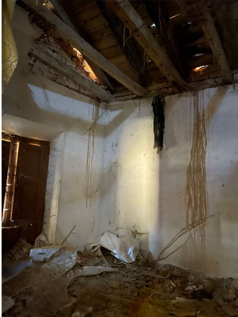
Ilustración 20. Foto interior. Desprendimiento de los forjados de la Casa del Cordón de Valdecañas de Cerrato. Fotografía propia, 28 de enero de 2022.
