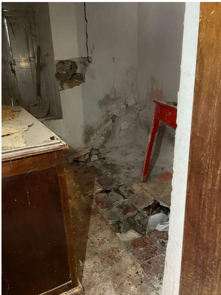
Ilustración 14. Foto interior. Estado forjado sanitario de la Casa del Cordón de Valdecañas de Cerrato. Fotografía propia, 28 de enero de 2022.
