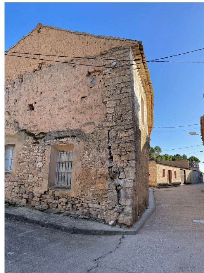
Ilustración 10. Grieta en esquina de la Casa del Cordón de Valdecañas de Cerrato. Fotografía propia, 26 de enero de 2022.
