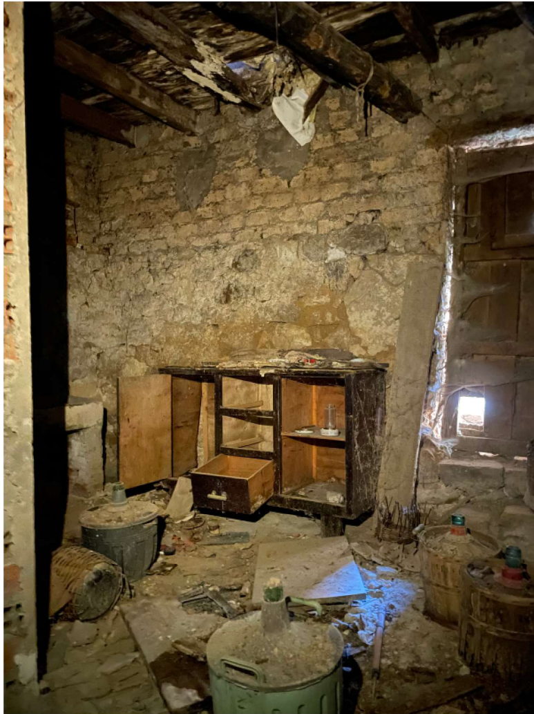
Ilustración 16. Foto interior. Desprendimiento de los forjados de la Casa del Cordón de Valdecañas de Cerrato. Fotografía propia, 28 de enero de 2022.
