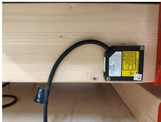
Figura 26. Disposición del sensor láser en el canto de la plataforma
