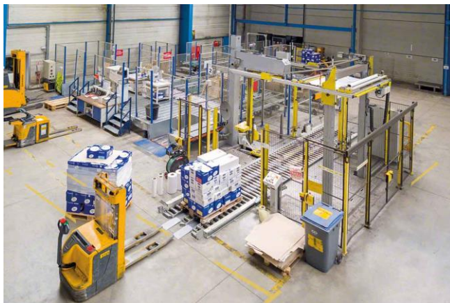
Ilustración 6. Almacén automático. Fuente: Mecalux.
