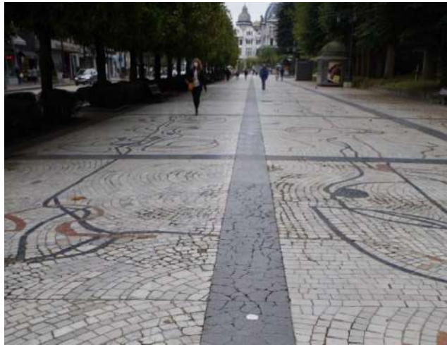
FIGURA 87: Deterioro del mosaico de Antonio Suárez. Fotografía de la autora.
