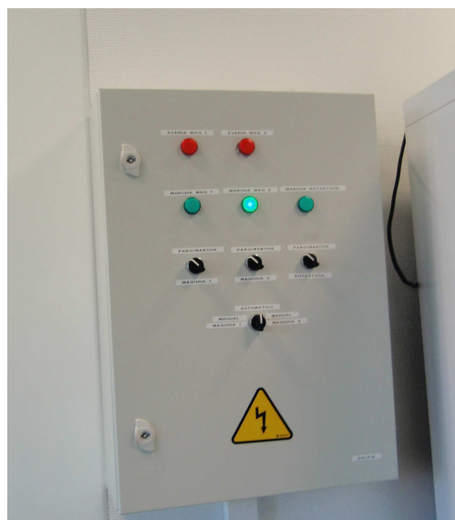
Figura 4.10 Cuadro eléctrico sistema de refrigeración. HCUV
