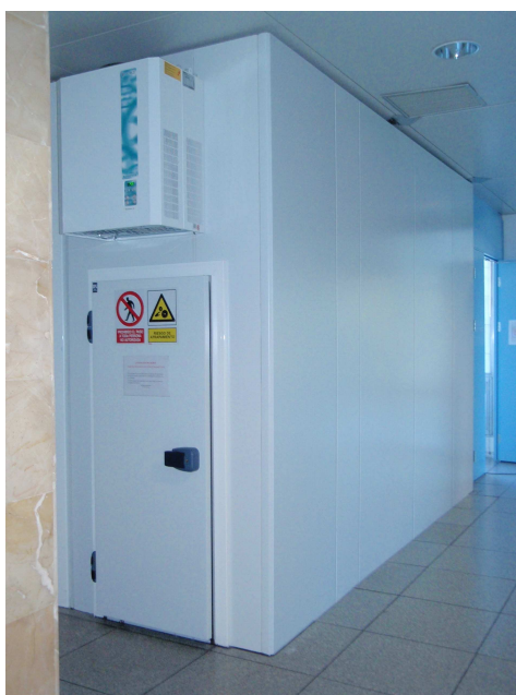
Figura 4.7 Cerramiento cámara frigorífica. Fundación Hematología y Hemodonación de CyL
