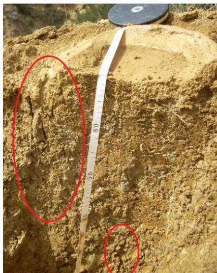
Figura 6.49. Detalle de las grietas aparecidas en el ensayo 4 con el infiltrómetro de 30 cm en el área degradada.
