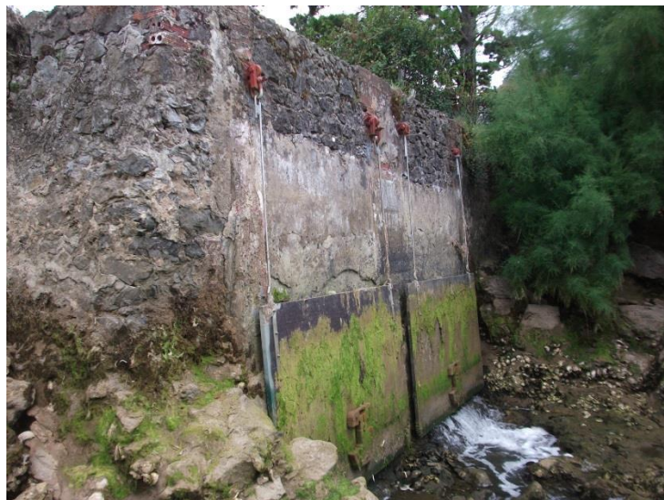
Figura 24: Compuerta con dos clapetas antirretorno en la desembocadura del Río Oriñón.
