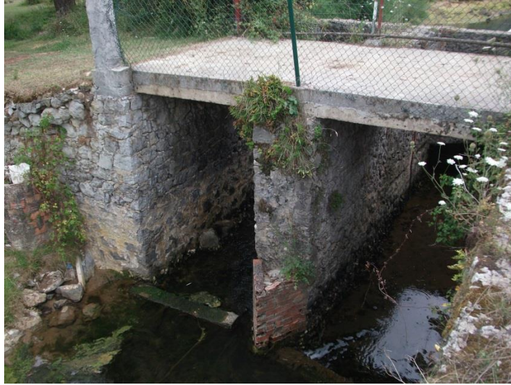
Figura 23: Entrada del agua a la compuerta que regula la carrera de las mareas.
