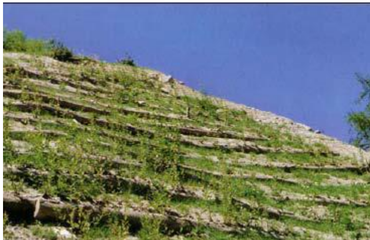
Figura 3: Ejemplo de enrejados vivos para estabilizar los taludes. Fuente: Estudio Integral para la recuperación hidráulico-ambiental del arroyo Borrico en Limpias)
