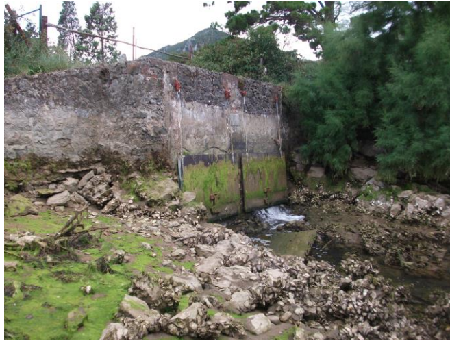
Figura 32: Compuerta con clapetas protegiendo al río de la marea.
