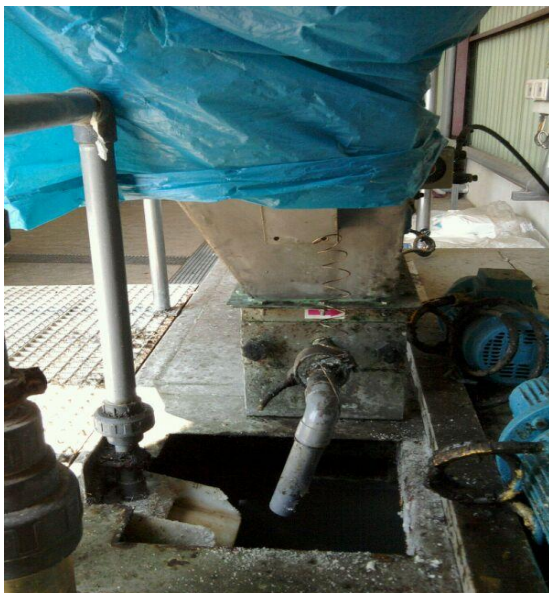
Foto 13. Tolva de almacenamiento de polielectrolito.
