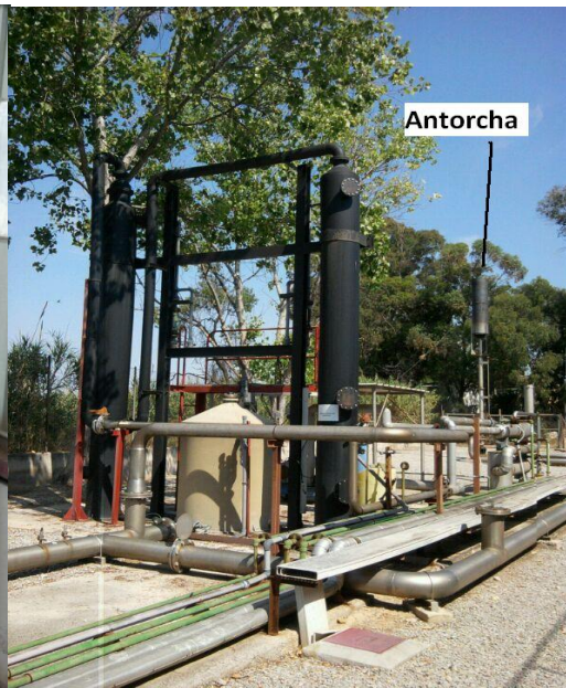
Foto 18. Scrubber o lavador de gases y antorcha.
