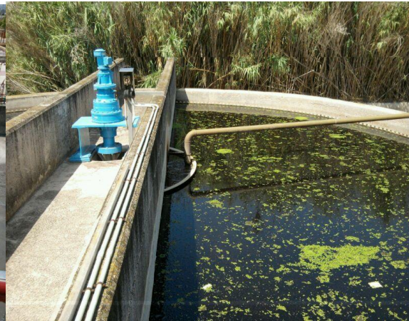
Foto 10. Espesador de fangos por gravedad
