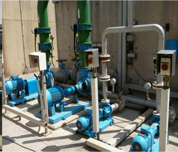
Foto 16. Bombas blending a la salida del homogeneizador
