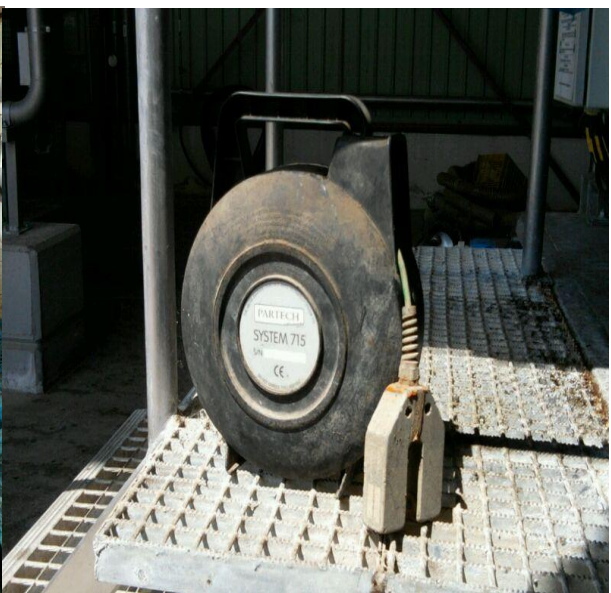
Foto 14. Sensor dotado de fotocélula que permite medir altura de lodo en espesador.
