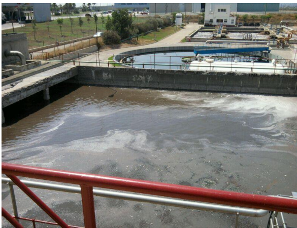
Foto 9. Tanque grande de emergencia y decantador secundario
