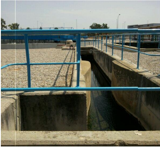
Foto 15. Canal de vertido final con un Parshall.
