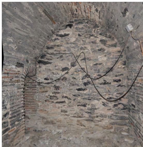
Fig. 41: interior de la segunda cámara. En el rincón, sobre la cara interior oeste, se sitúa el acceso al tramo de escaleras que asciende desde este nivel hasta el del cuerpo de campanas. También es reseñable la abundancia de piezas de mampostería con la que se construye la cara interior del lado norte así como la gran cantidad de ladrillos presentes en las caras este y oeste, lo que denota una cierta riqueza constructiva.
