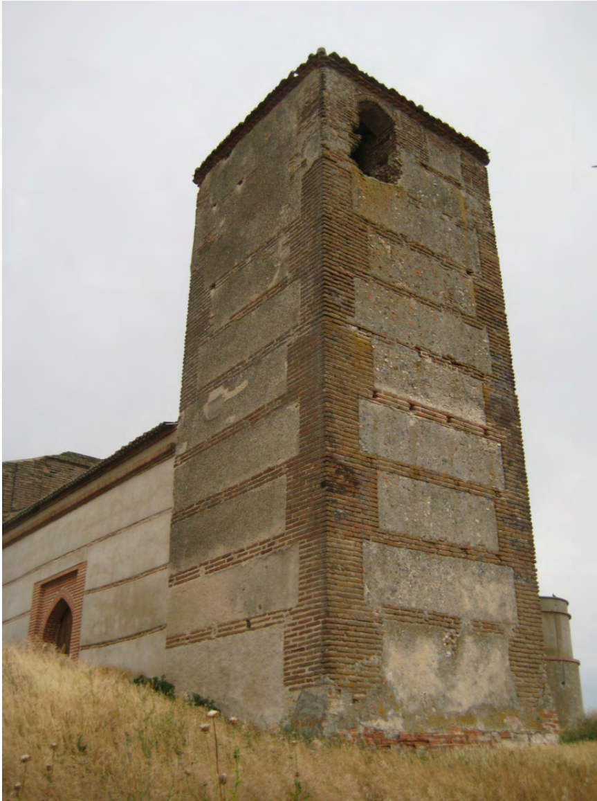
Fig. 13: flanco noroeste de la torre. Se aprecia perfectamente la falta de conexión entre las hiladas de la torre y las del muro norte de la iglesia.
