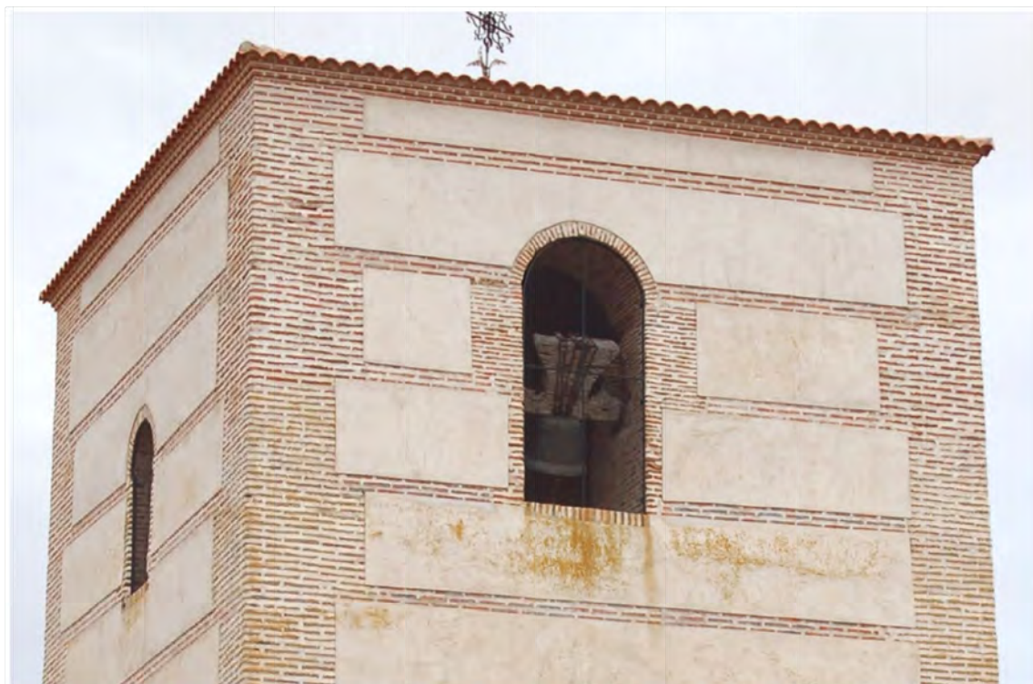
Fig. 37: fotografía de detalle del costado suroeste de la torre de San Esteban de Zapardiel. En ella se observan algunas anomalías en la disposición de los ladrillos a partir de la verdugada sobre la que se abre la ventana. Estas irregularidades corresponden internamente con el cambio en el espesor del muro.
