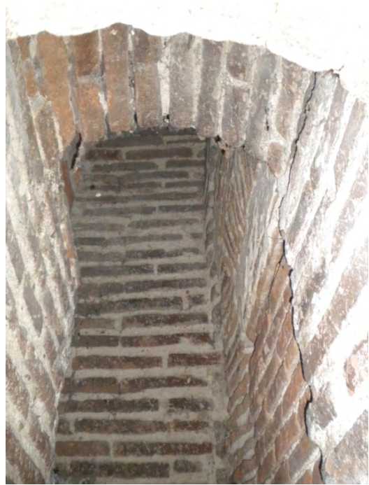
Fig. 31: tercera bóveda, en sentido ascendente sobre la escalera de fábrica. Se distingue un perfil próximo al de un arco escarzano.
