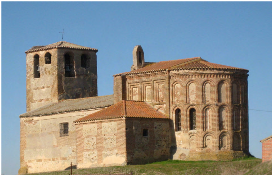
Fig. 9: vista general de la iglesia parroquial de San Cristóbal de Trabancos desde el sur. Se aprecia claramente que el ábside, el cuerpo de la sacristía y el conjunto formado por la torre y el muro sur de la iglesia corresponden a diferentes momentos constructivos.
