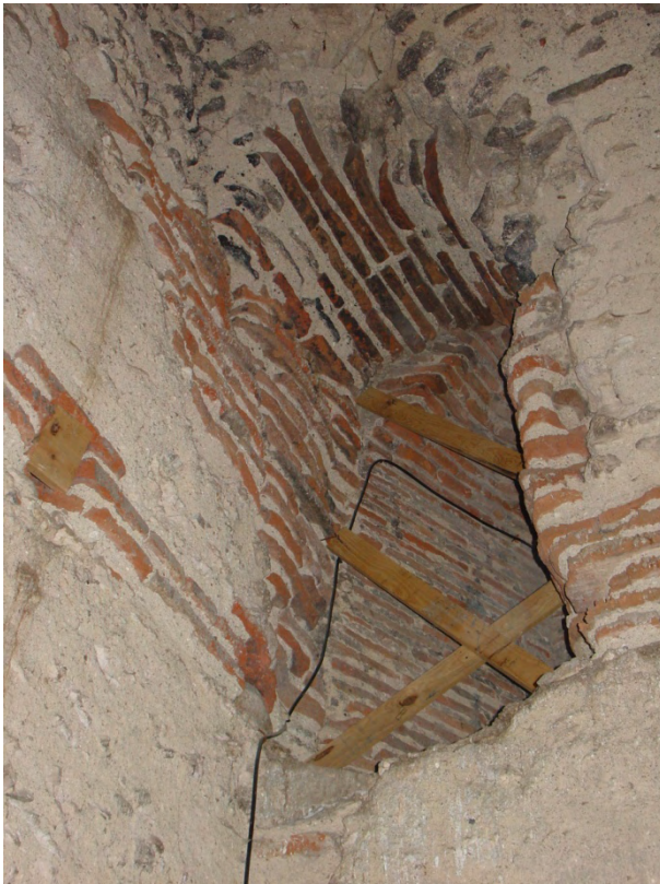
Fig. 16: puerta abierta en la bóveda de cañón de la segunda cámara, sobre el muro norte. Esta puerta se utilizaba para acceder al forjado de la parte superior de la segunda cámara.
