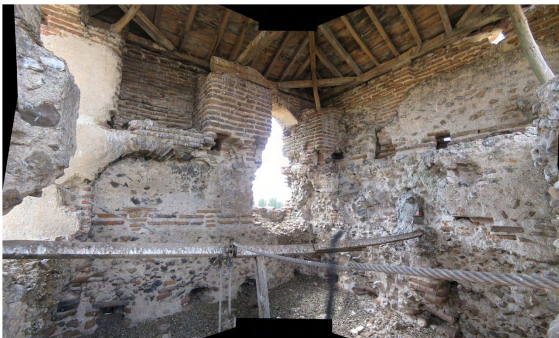
Fig. 37: composición fotográfica que permite ver las caras internas oeste y norte del campanario. En la imagen se aprecia el recrecido interior de los muros y el ritmo impuesto por los machones que se edifican encima.
