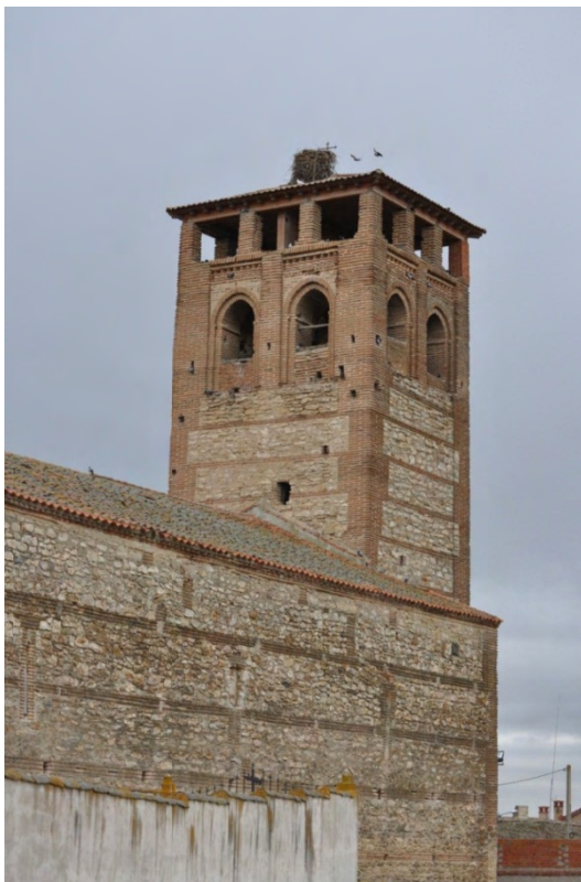
Fig. 25: fachada este de la torre de Espinosa de los Caballeros. En ella se aprecia el hueco de salida a cubiertas sobre las trazas de un levante previo de las mismas.
