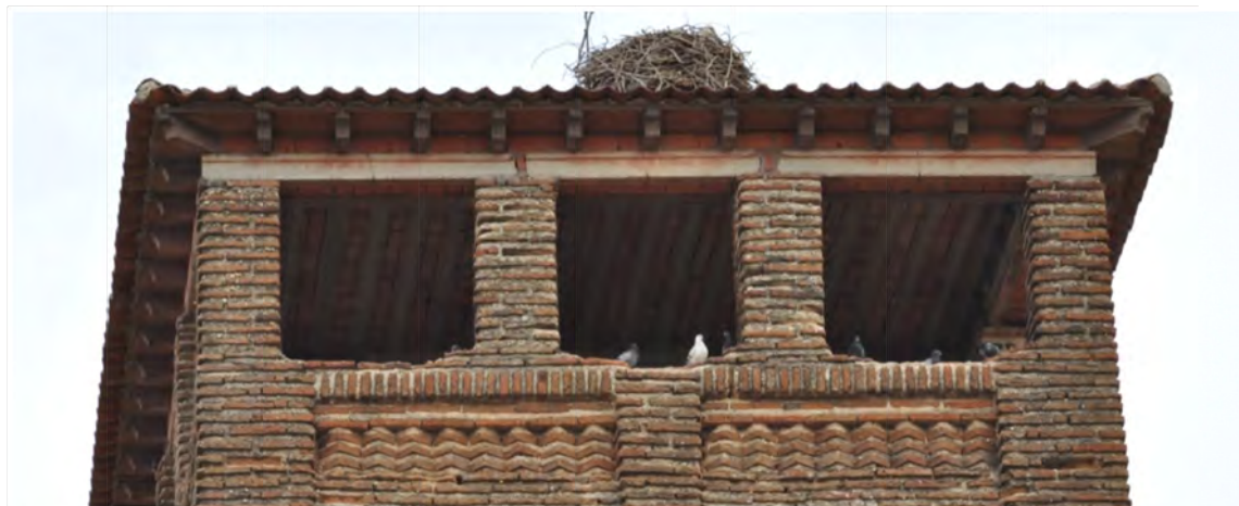
Fig. 63: detalle de la coronación de la torre de Espinosa. La secuencia de soga-tizón es la misma que la que se da en el machón central que separa los recuadros rehundidos de las campanas. Las dimensiones son exactamente las mismas y no se aprecia ningún corte que signifique una discontinuidad en la fábrica.
