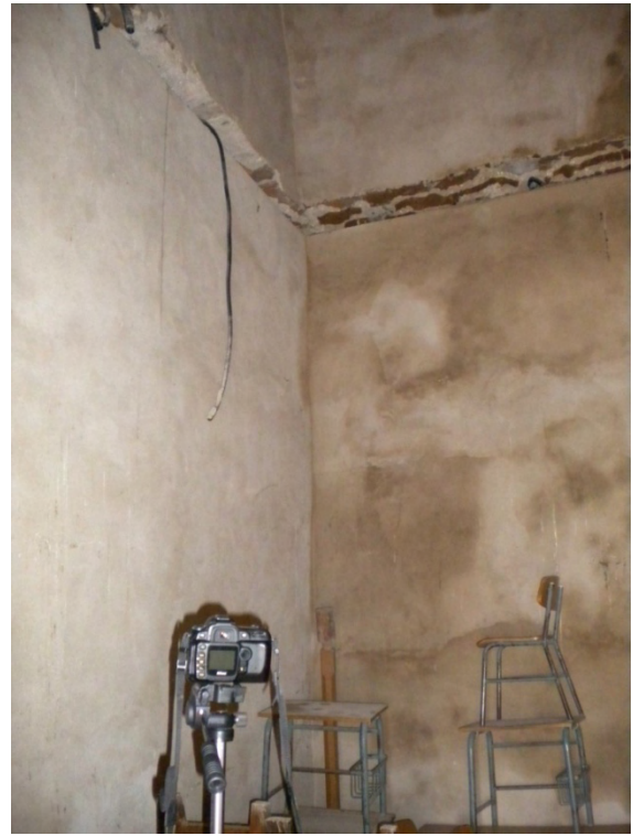
Fig. 19: roza que se abre en el perímetro de la primera estancia, a la altura del arranque de la bóveda. Se abre para la colocación de puntos de luz y deja al descubierto la cara interna de una de las verdugadas medievales de ladrillo.
