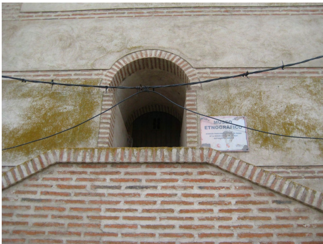
Fig. 8: segunda puerta abierta en la fachada NE de la torre de San Esteban de Zapardiel. El recercado de ladrillo de las jambas y el arco de medio punto son producto de la intervención de rehabilitación de la torre para transformarla en museo etnográfico.
