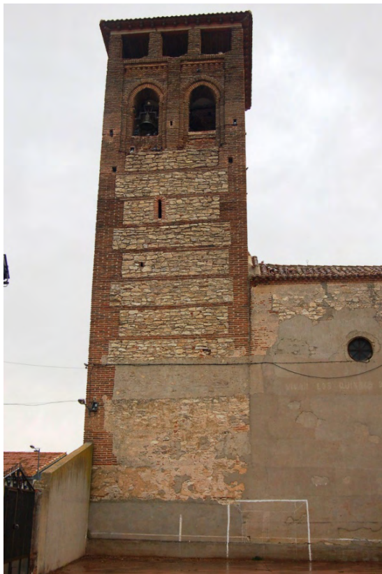
Fig. 7: zona de encuentro entre la torre y el muro sur de la iglesia. Las cinco primeras cajas contando desde el suelo aparecen sin reforzar en la esquina sureste. A partir del quinto cajón se observa claramente la independencia entre la fábrica de la torre y la del muro del templo.
