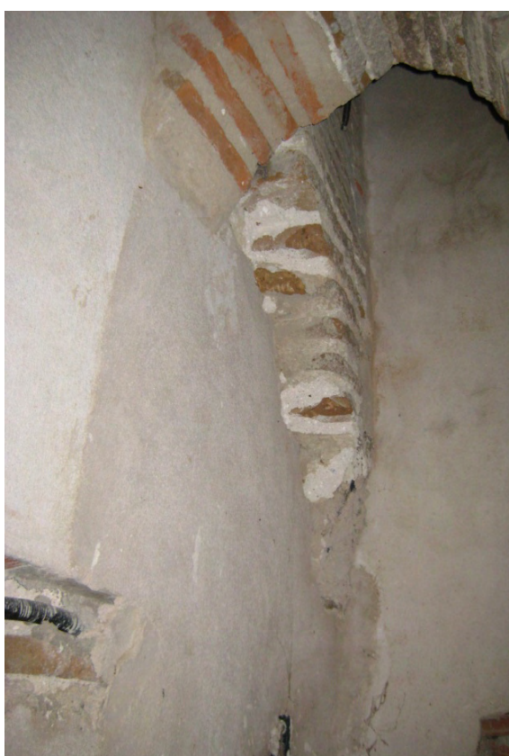
Fig. 25: final del primer tramo de escaleras, también clausurado. Se encuentra en el rincón definido por los muros NO y NE de la torre. En la huella se lee el perfil de una bóveda de medio cañón apuntado.
