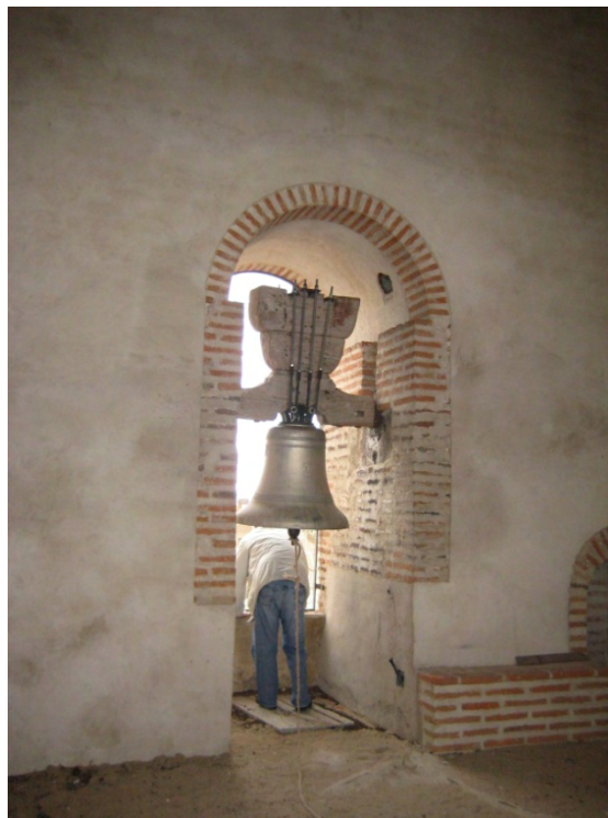
Fig. 31: ventana de la segunda cámara en la cara interna del muro nordeste. Se aprecia en la fotografía cómo las rosca de los arcos están completamente rehechas con ladrillo reciente.
