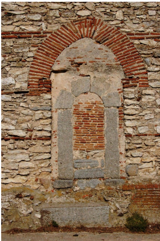
Fig. 17: puerta sobre la fachada oeste en Espinosa de los Caballeros cuya misión era la de acceder a través de un pasadizo abovedado al interior del templo. No se trata, pues, del ingreso a la torre. Se observa la poco convencional solución de la rosca apuntada de ladrillo, que da lugar a una colocación confusa de los ladrillos en la zona de la clave.
