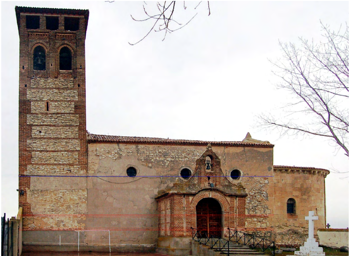
Fig. 10: Sobre la imagen rectificada de la fachada sur se destaca a línea de puntos roja la concordancia entre las hiladas de la torre y las de la parte baja del muro de la iglesia. A línea de puntos azul se marca el límite del quinto cajón sin reforzar, que muy probablemente estuvo relacionado con la altura de los muros del primitivo templo mudéjar.
