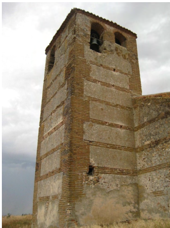
Fig. 12: esquina suroeste de la torre. En ella, el refuerzo en esquina recorre los cajones inferiores hasta alcanzar el cuerpo de campanas. Es patente la continuidad de hiladas entre el muro sur de la torre y el muro oeste de la iglesia.
