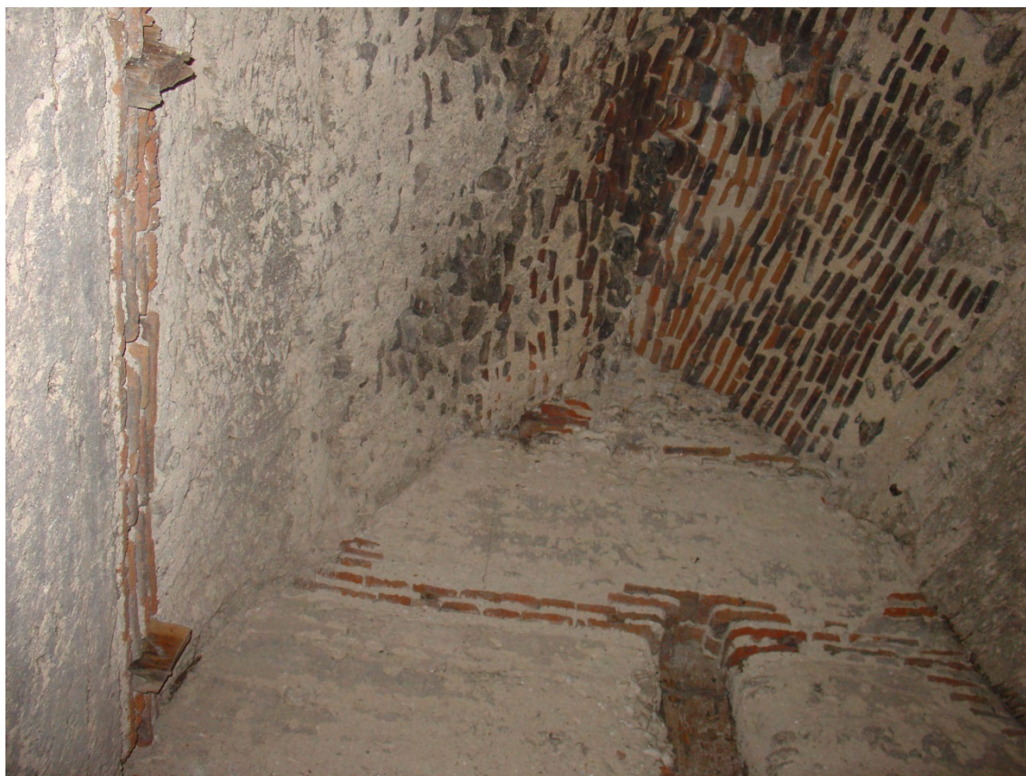
Fig. 22: Segunda cámara de la torre de Aldeaseca en la que se aprecia cómo se resuelve la bóveda: en la parte próxima a la arista, se apiñan los ladrillos colocados a soga, mientras que, a medida que nos alejamos del eje éstos se sustituyen por mampuestos.
