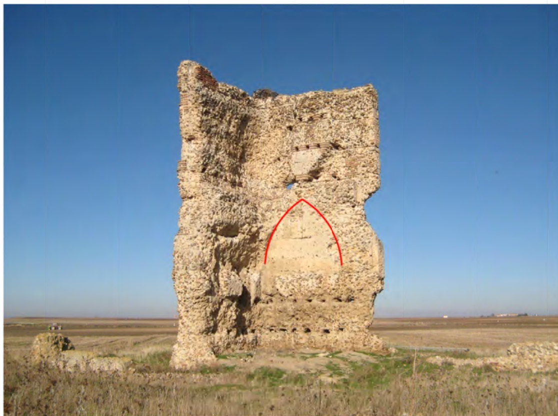
Fig. 52: ruinas de la torre de Astudillo. Se señala en rojo la traza de la bóveda de cañón apuntada que se distingue in situ .
