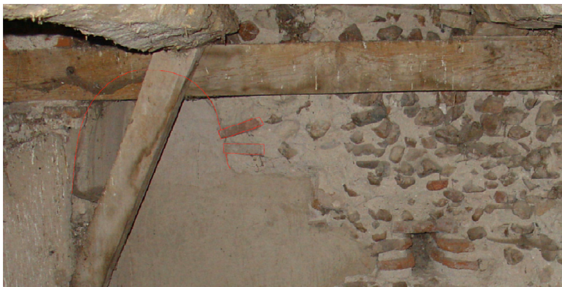
Fig. 32: rincón SO en la parte interior de la torre. Se marcan en rojo, tras los postes de madera, dos ladrillos y un relleno que podrían corresponder a la huella del tramo de escaleras perpendicular a la fachada oeste y que recorrería el interior del muro sur hasta alcanzar un hipotético cuerpo de campanas.
