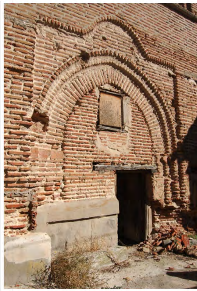
Fig. 20: puerta centrada en la cara oeste de la torre de San Nicolás de Bari en Madrigal de las Altas Torres. Tras ella existe un pasadizo resuelto mediante bóveda de cañón y se ha podido verificar que se trataba del ingreso a un templo con el que indudablemente la torre primitiva estuvo relacionada. Si bien este acceso corresponde al refuerzo externo que se construye a finales del siglo XV o principios del XVI, en el interior es visible la estructura del paso primitivo original. Dicho paso tiene un aspecto muy similar al de la torre de Espinosa.
