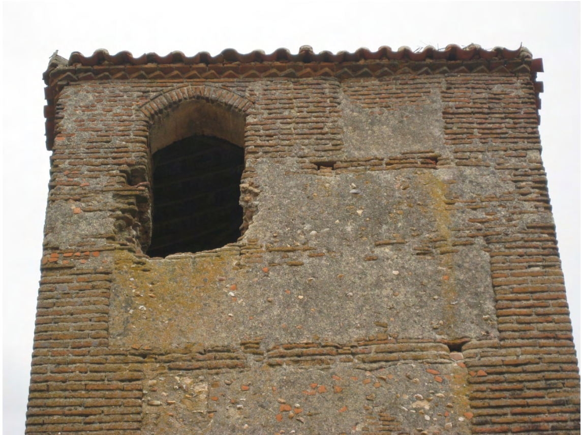
Fig. 15: costado oeste del cuerpo de campanas. Cuenta con un solo hueco en el lado izquierdo que se cierra con arco escarzano. Se aprecia en la parte superior derecha un hueco almenado relleno de ladrillo correspondiente a otra época. El hueco que existe en la actualidad se abre en el espacio existente entre dos almenas.
