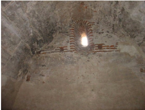
Fig. 20: hueco aspillerado en la parte central de la cara interna sur en la primera cámara. Se observa asimismo cómo junto a él hay un relleno de ladrillo que tapa una perforación que se hizo para permitir el paso de las sogas para tañer las campanas.
