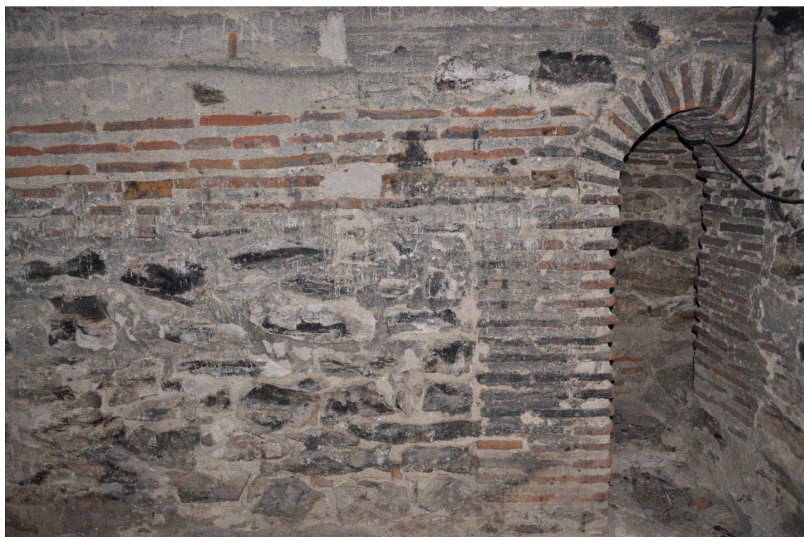
Fig. 43: acceso a las escaleras por las que se asciende al campanario desde la segunda cámara. Son visibles en la verdugada horizontal de ladrillo desde la que arranca la bóveda los mechinales, que aún conservan fragmentos de madera en el interior. Parece que no pudo tratarse de un forjado porque, de haber sido así, no se habría podido acceder a la cámara desde la puerta que se encuentra en el muro de enfrente. Se trata, con toda seguridad, de los restos de la estructura auxiliar del encofrado de la bóveda.
