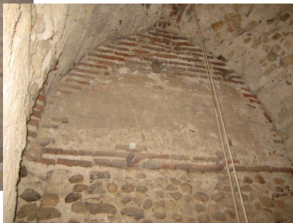
Fig. 26: bóveda de la cámara primera de la torre de San Cristóbal de Trabancos. El perfil de la fotografía es el que se recorta en la cara interior del muro sur. Se aprecia el remate de ladrillos cerca de la clave, la verdugada ejecutada sólo con dos hiladas de ladrillo y las dimensiones considerables del árido que constituye la areamasa.
