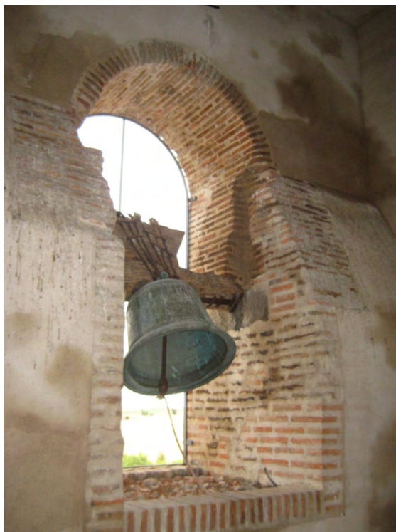
Fig. 32: ventana de la segunda cámara en la cara interna del muro suroeste. El ladrillo que recerca el hueco es también anterior a la rehabilitación de la torre. Parece estar relacionado con el refuerzo lateral en el que se encastra el eje de la campana, pues presenta las mismas características. Sin embargo, aunque también anterior es de época distinta al de la fachada noroeste.
