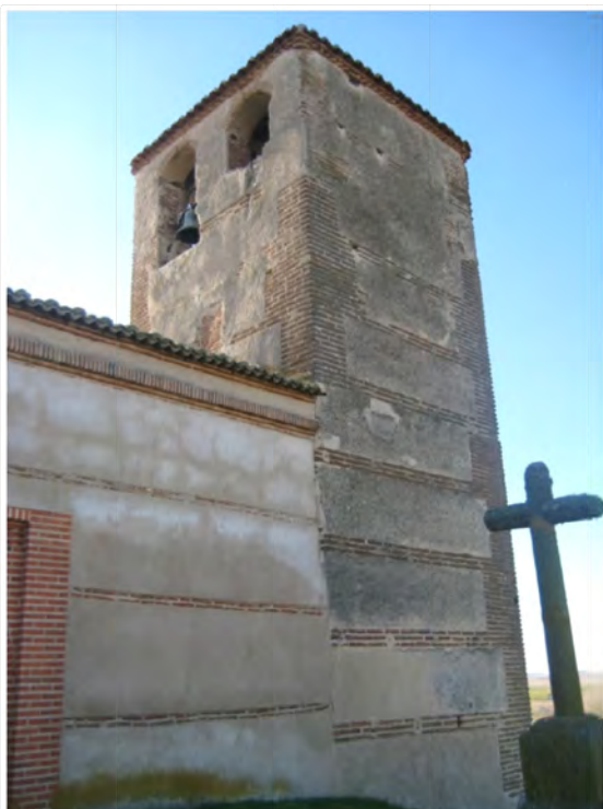
Fig. 11: esquina nordeste de la torre. El refuerzo en esquina no aparece en las hiladas inferiores puesto que la torre se integra desde su construcción original con el edificio parroquial, tal y como puede constatarse en la continuidad de verdugadas en el costado sur.
