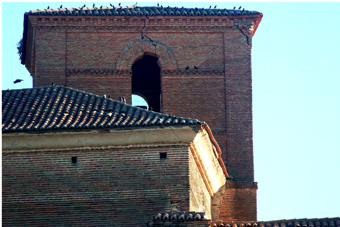
Fig. 27: Costado norte de la torre en el que se aprecia la profunda grieta sobre la clave que ha provocado la caída del 25 % de las piezas de la rosa interna del arco. También se observa cómo en la esquina superior derecha, a la altura de la cornisa, hay un riesgo inminente de desprendimiento de ladrillos.
