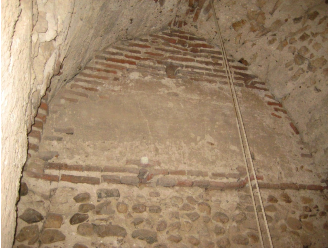
Fig. 14: cámara de la torre de San Cristóbal de Trabancos. Se observa cómo se dibuja el perfil de la bóveda de cañón apuntada mediante ladrillos colocados a soga sobre los que se apoyó una cimbra a base de tablones de madera. Restos de esta cimbra son aún visibles en casi todos los casos de torres estudiadas (incluido éste) en el encuentro entre el muro vertical y la parte de la bóveda que en él se apoya
