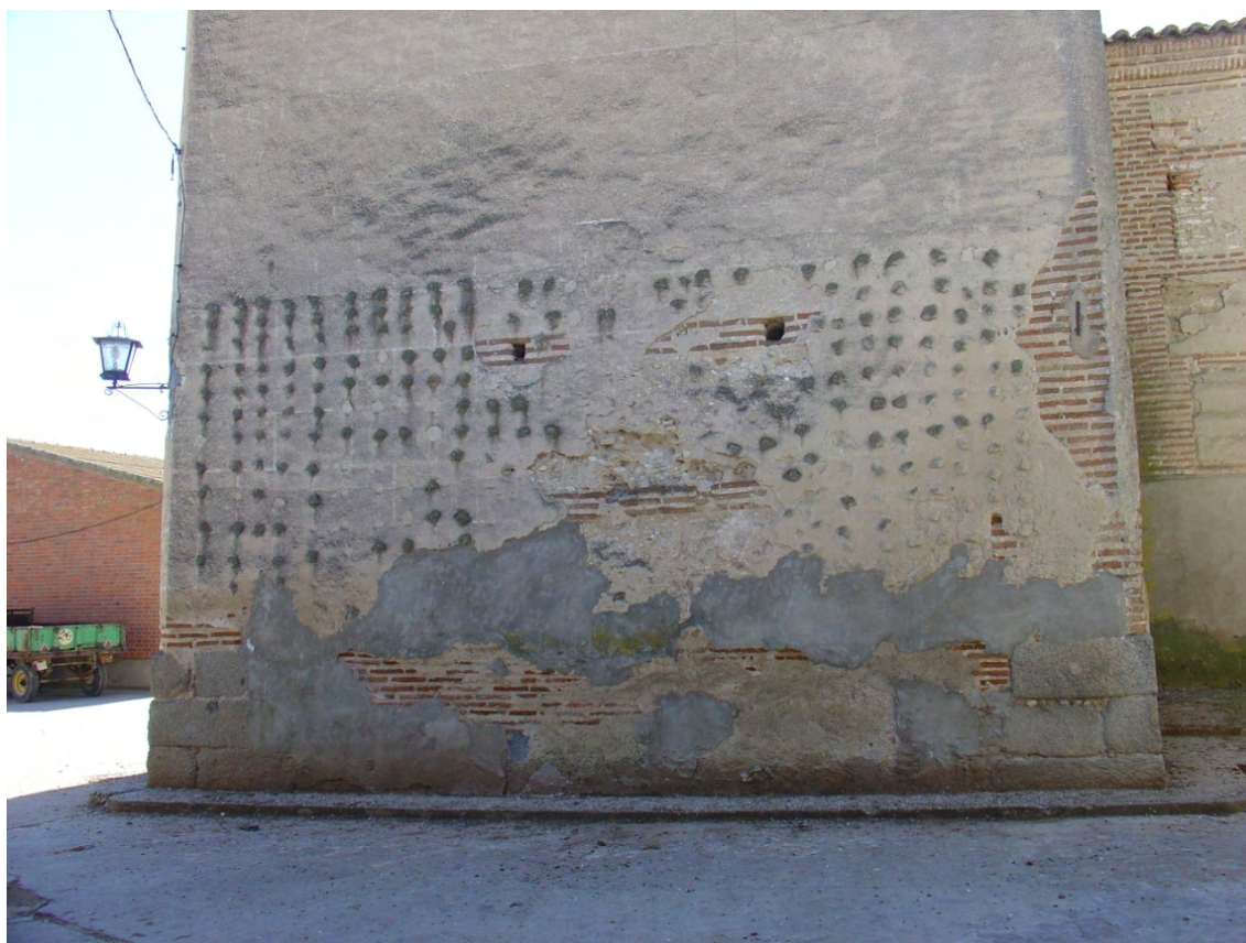
Fig. 6: Lado norte de la base la torre en el que se aprecian las huellas del esgrafiado sencillo que emula un despiece regular de sillería. Sobre el esgrafiado quedan restos de escoria que tenía una función protectora del muro frente a los impactos de balón.
