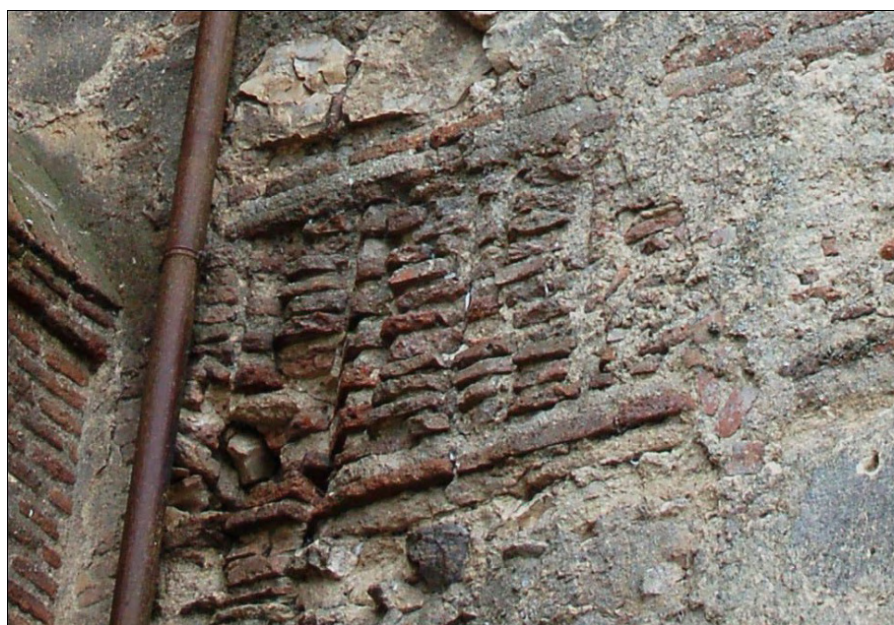
Fig. 44: restos del friso de esquinilla en el ángulo superior izquierdo de la fachada norte.
