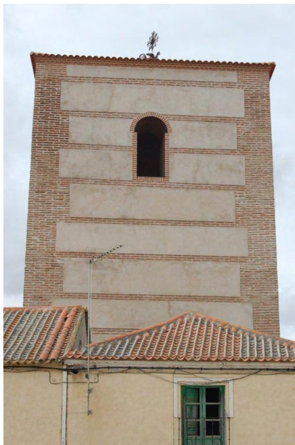
Fig. 11: costado SE de la torre de San Esteban de Zapardiel. El recercado del hueco es completamente nuevo y su aspecto actual corresponde a las obras de rehabilitación para la adecuación de la torre como museo. Su forma y disposición son idénticas a las que aparecen en el hueco de la puerta de entrada y muy similares a las de la fachada NE.
