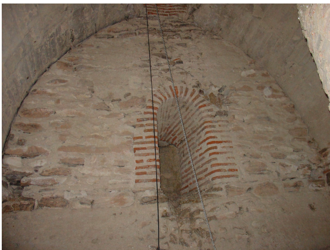
Fig. 15: bóveda de cañón ligeramente apuntada de la primera cámara de la torre de San Andrés. En la zona de la clave se observa una rotura que se practica para pasar las sogas de las campanas. Son visibles asimismo las huellas de las tablas que conformaron el encofrado de la bóveda.
