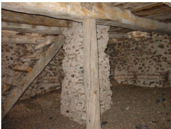
Fig. 27: machón central que sostiene el forjado de madera sobre cuya cara superior se encuentra el espacio destinado a campanario. También se observa la escalera que sube al actual campanario.
