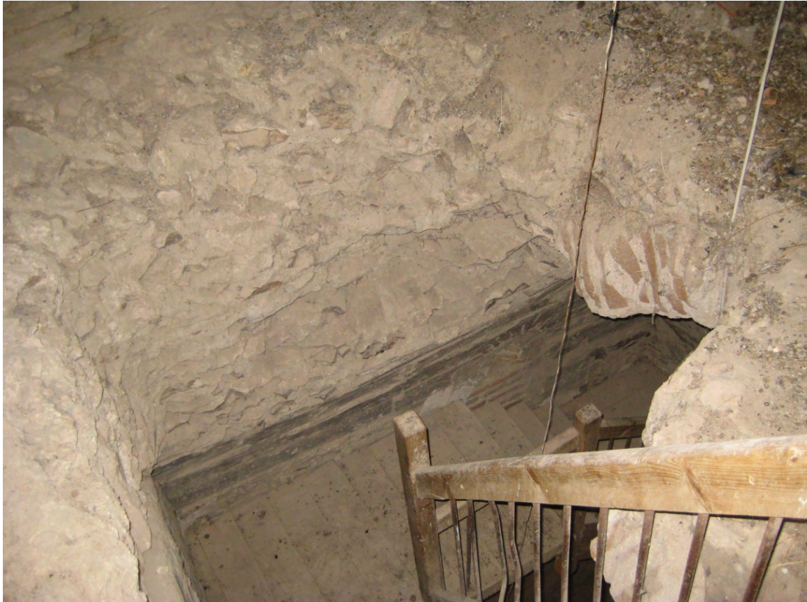
Fig. 21: Rotura de bóveda entre la primera y la segunda cámara de la torre de Sinlabajos. Se aprecian en la fotografía los estratos que componen la sección: en primer lugar (de arriba abajo) la argamasa de cal y canto cuyo aspecto en nada difiere de los vistos rellenando cajas en otras torres; inmediatamente debajo, los ladrillos colocados de canto que voltean la forma de la bóveda y que se apoyaban directamente sobre la cimbra y, más abajo, la textura de los tablonos de madera originada por la impronta que sobre la lechada de cal dejaron éstos.
