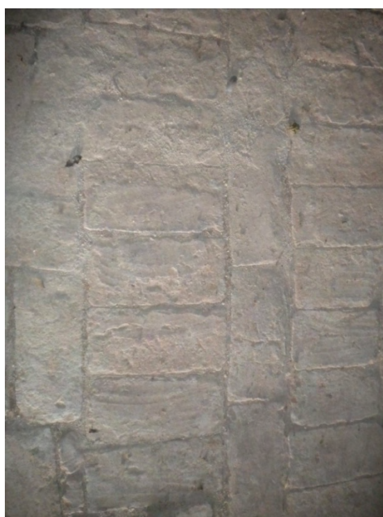
Fig. 17: pavimento antiguo que determina que el nivel de acceso que se proyecta en la rehabilitación corresponde a una cota preexistente, probablemente la más baja también en la torre original.
