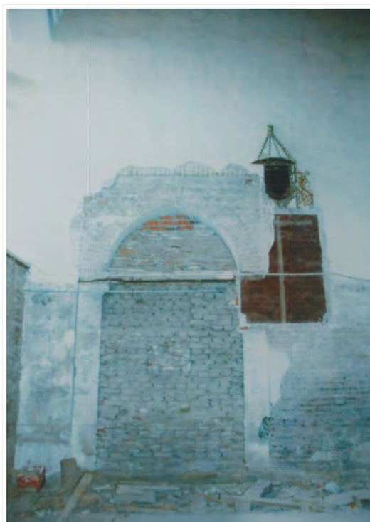
Fig. 68: puerta perteneciente al forro exterior del costado este de la torre de San Nicolás. Tras las obras de restauración del coro, la puerta quedó oculta.
