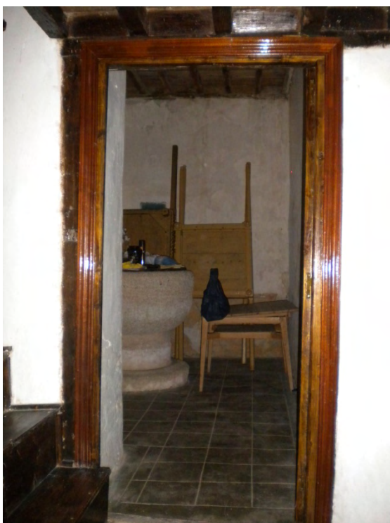
Fig. 22: puerta de acceso a la estancia inferior de la torre. Sobre ella se sitúa el forjado del coro, cuya altura habría correspondido aproximadamente con la del forjado primitivo que separó la primera cámara en dos recintos.
