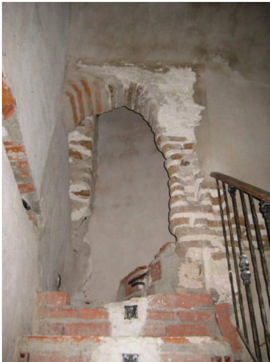
Fig. 22: puerta perteneciente a la fábrica mudéjar que se sitúa a la misma altura que la línea de mechinales en los que se encastraba un forjado de madera. Esta puerta era el acceso al forjado. Para alcanzar la cota de forjado se ascendía por escaleras insertas en el muro que ascendían desde la puerta de ingreso. Quedan restos suficientes para conocer que su perfil era apuntado.
