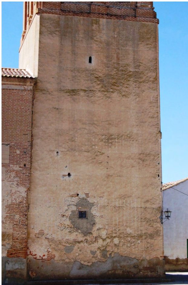
Fig. 5: Lado este del fuste de la torre en el que se aprecian las huellas del esgrafiado sencillo que evoca un despiece regular de sillería. En este costado se abren los dos únicos huecos visibles desde el exterior con los que cuenta el fuste medieval. Sólo el hueco superior tiene relación con la fábrica original.
