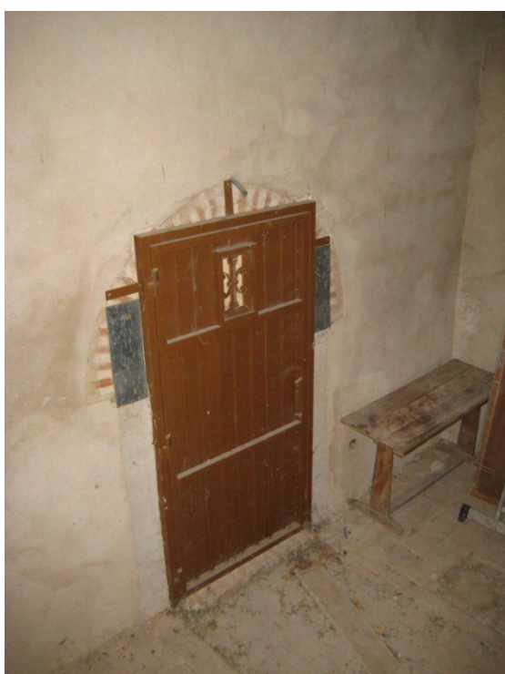
Fig. 16: puerta de cierre del actual ingreso a la torre. Se aprecia cómo entra en conflicto la forma rectangular de la puerta con el perfil del arco de medio punto que conforma la bóveda de cañón a través de la que se accede al interior de la torre.
