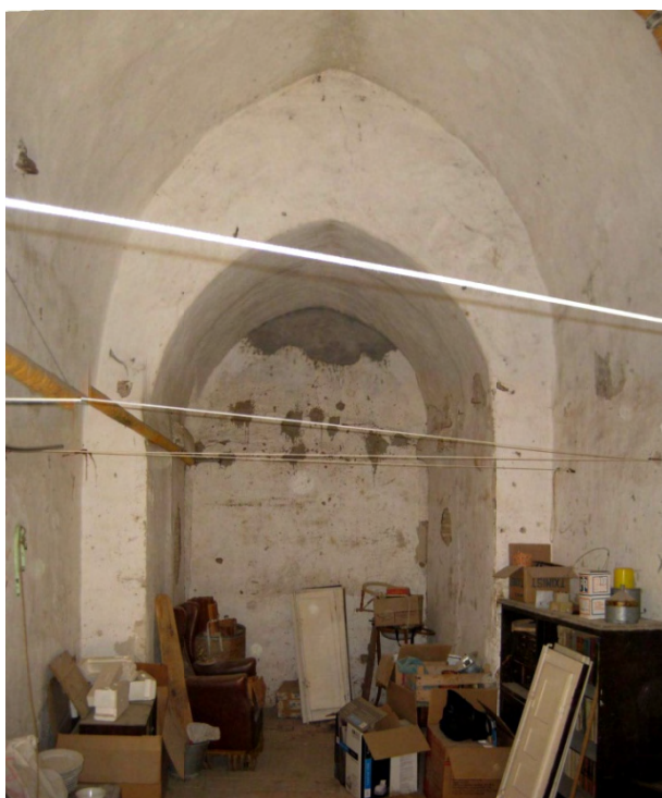
Fig. 67: en la zona en la que se reduce la sección del “túnel-pasadizo” bajo la torre se aprecia el recorrido de la nacela que arranca del arco que se ve en la foto contigua (fig. 68). La nacela termina justo en el lugar en el que se abre una grieta que marca claramente la separación entre la torre primitiva y el forro de finales del XV o principios
