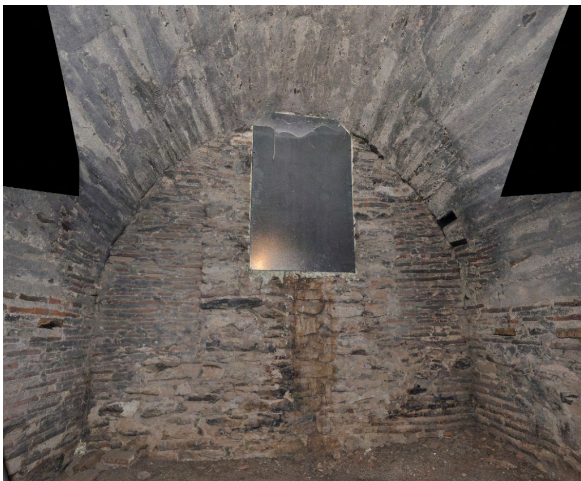
Fig. 38: Primera cámara. Cara interior oeste. No se han podido examinar las características del interior de la primera ventana de la torre pues se halla oculta tras una chapa metálica. En la foto se aprecia cómo en todo el perímetro de los muros verticales de la cámara, no se escatiman ladrillos, a diferencia de lo que ocurre en otras muchas torres. Son visibles las huellas del encofrado de madera que sirvió para modelar la bóveda.
