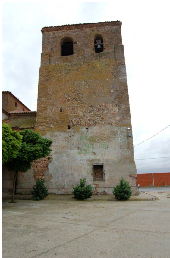
Fig. 7: fachada oeste de la torre de Castellanos de Zapardiel. Los huecos con los que cuenta son los dos del campanario, una pequeña abertura entre las dos franjas verticales de ladrillo a media altura y la puerta del granero.
